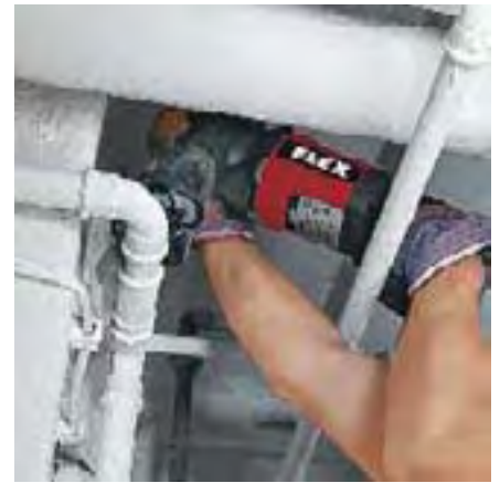
... oder Rohre im hintersten Winkel.
